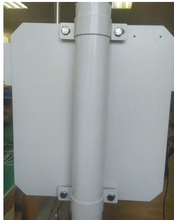
安装完成背面图
