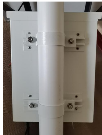
安装完成背面图
