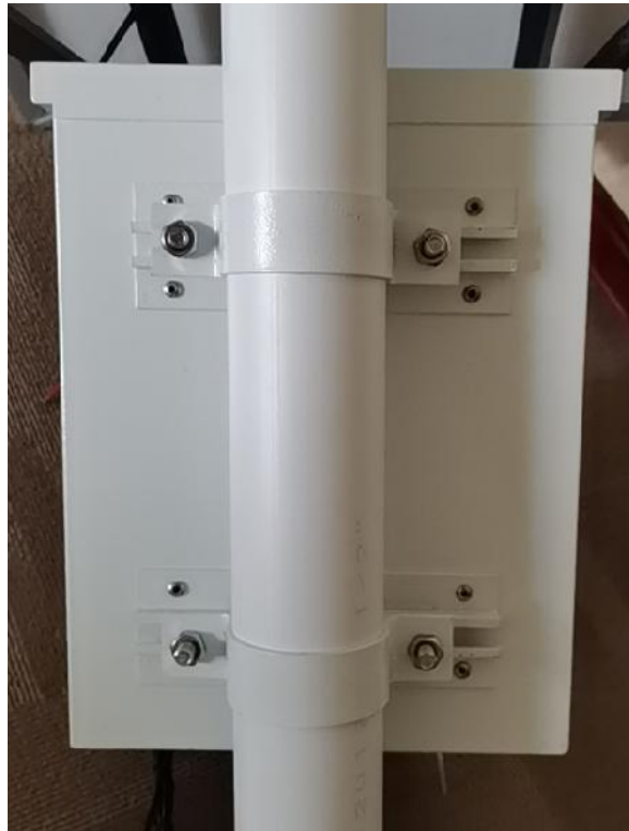
安装完成背面图
